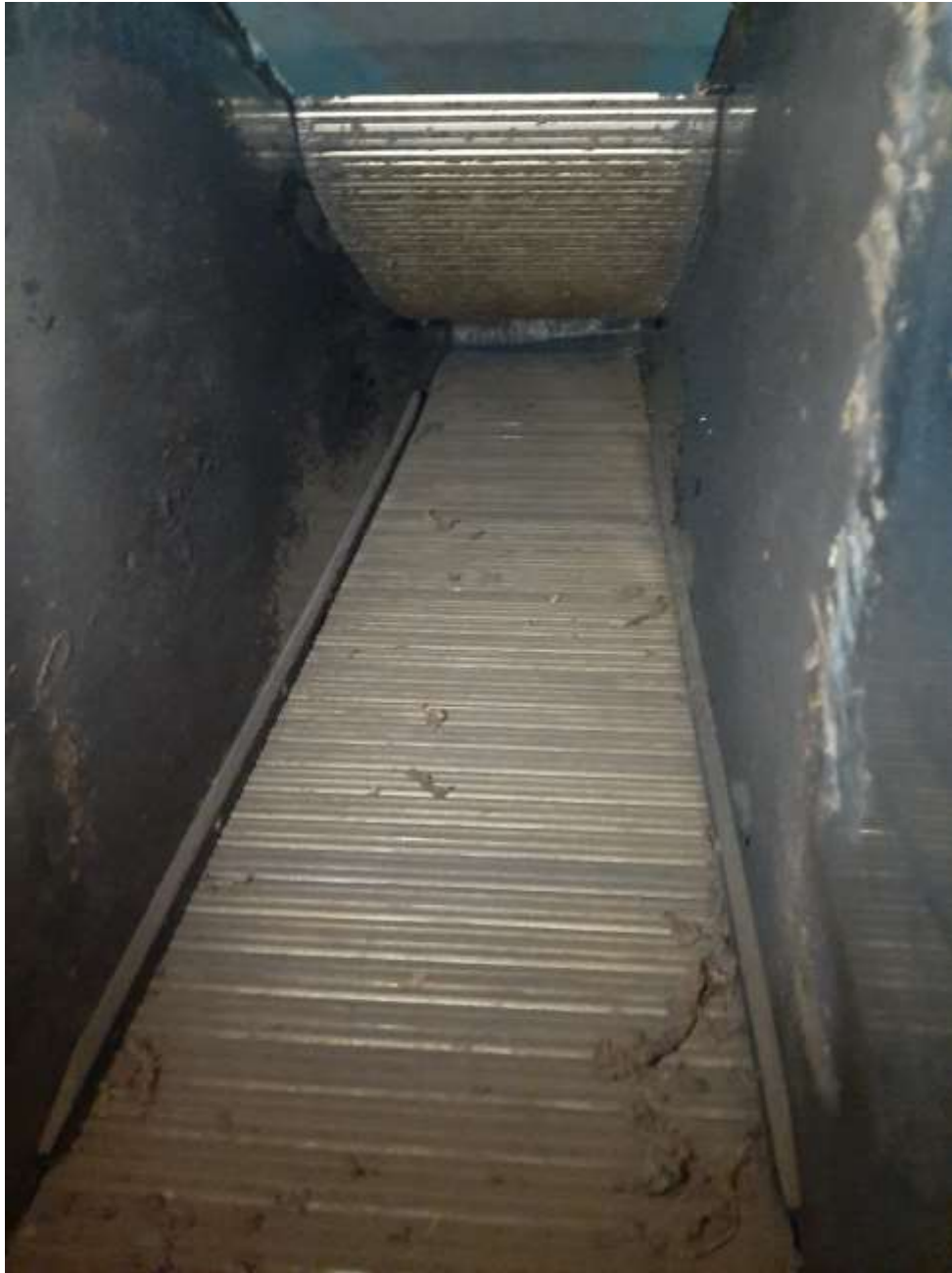
الشكل(1) لوحات الوصل النحاسية تشكل السلسلتين الناقلتين العلوية والسفلية (الملاحظات المرئية في موقع العمل).
